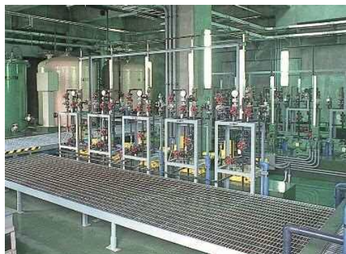
熱塩浄水場薬品注入設備
